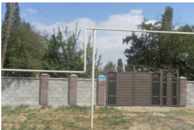
Фото 16 - Система газоснабжения поселка
