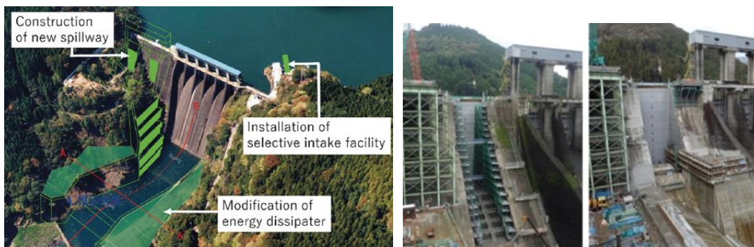
Рисунок 5-15 Пример изменения водозаборного и водопропускного сооружения на плотине Нагаясугучи (Сасаки и Кондо, 2018)
