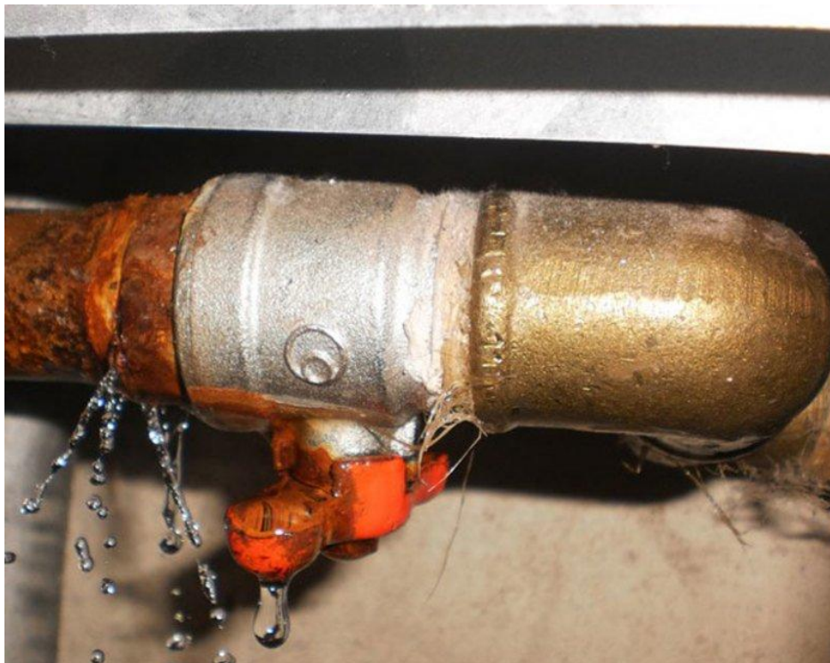
Рисунок 1 - Нарушение герметичности элементов системы отопления
