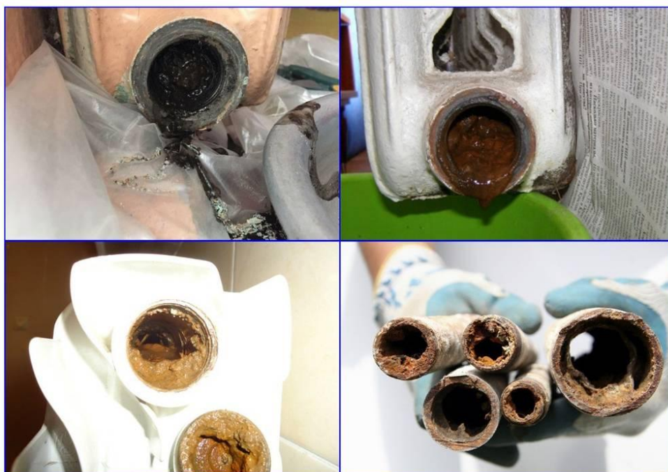
Рисунок 2 - Засоры и отложения продуктов коррозии.
