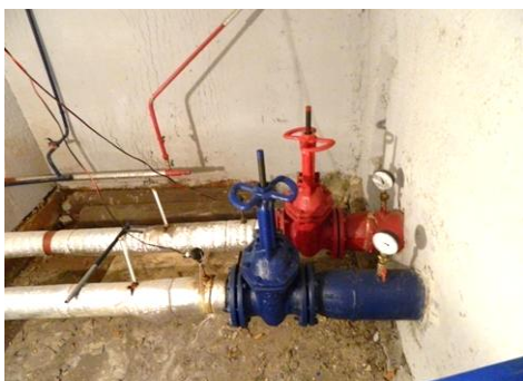
Рисунок 2 - Элеваторный узел теплового пункта
