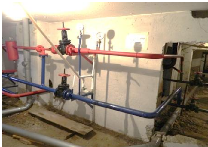
Рисунок 1 – Индивидуальный тепловой пункт многоквартирного жилого дома по адресу: г. Саратов, ул. Одесская, д. 24 А
