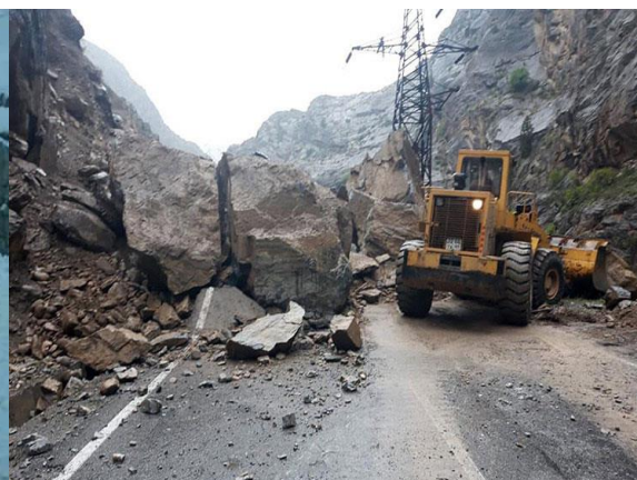
Рисунок 2. Камнепады на 94-95 километре автомобильной дороги Вахдат-Рашт-Ляхш
