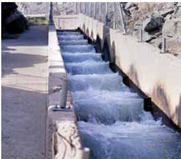
Рисунок II.4.23. Пример рыбохода из прудков и сливных порогов, позволяющий рыбе обходить дамбу и достигать более высокого уровня воды через ряд низконапорных плотин
