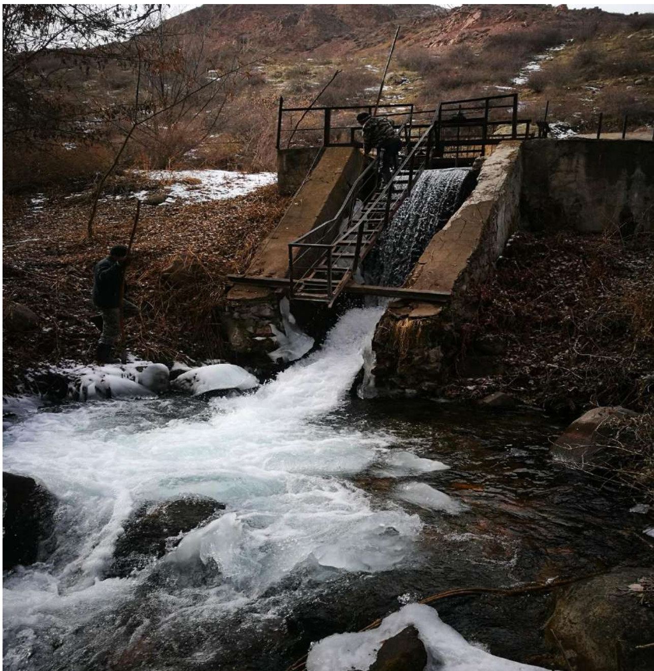
Рисунок 11 - Аварийный сброс из канала АГПТ
